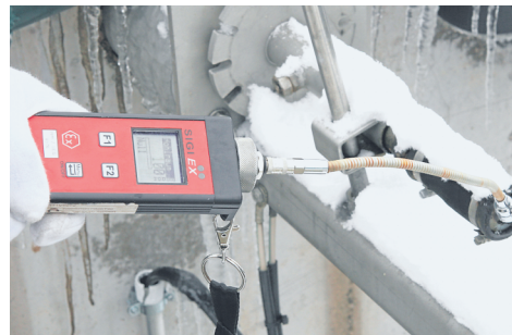
Mit dem „Schnüffler“ wird die genaue Gas-konzentration an auffälligen Stellen gemessen.
