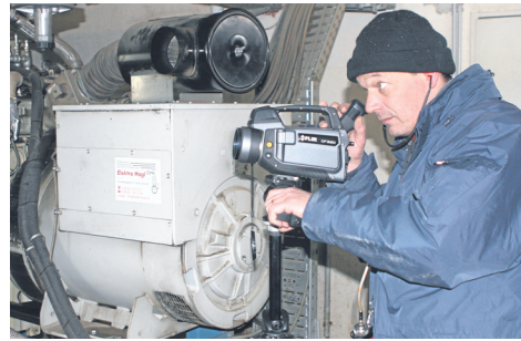
Auch das Blockheizkraftwerk wird geprüft
