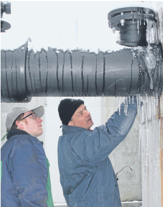
Undicht: Ortwin Faul zeigt Johannes Hopp (l.), wo er Gasaustritt festgestellt hat.
